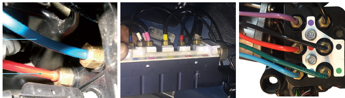
Beispiel verschiedener Leitungen
