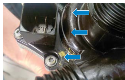
标配泵可能出现的问题: 塑料壳体破裂。
